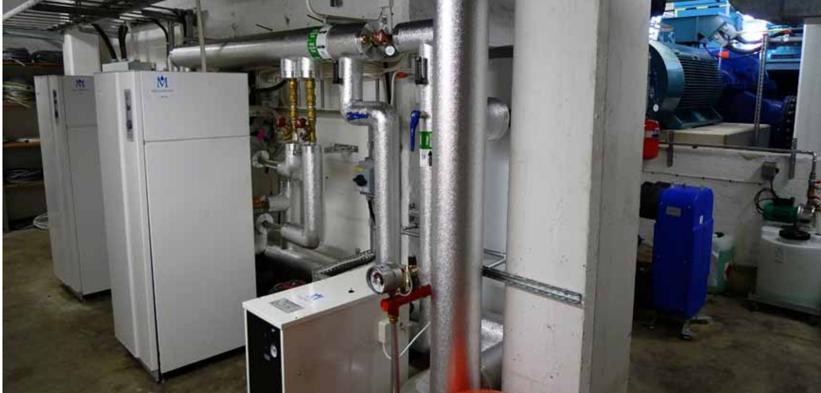
Ny värmeanläggning vid Vombverket
