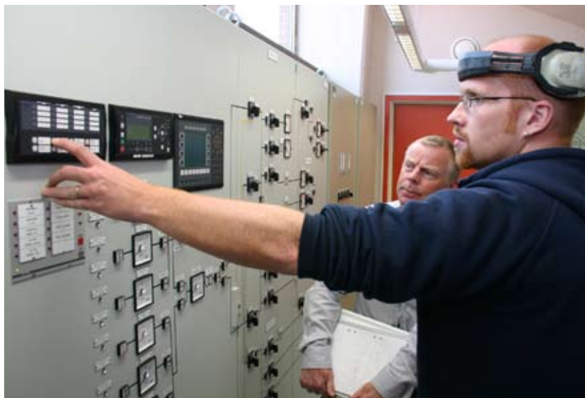
Central kontrolltavla för manövrering av hela Vombverkets reservkraft.
