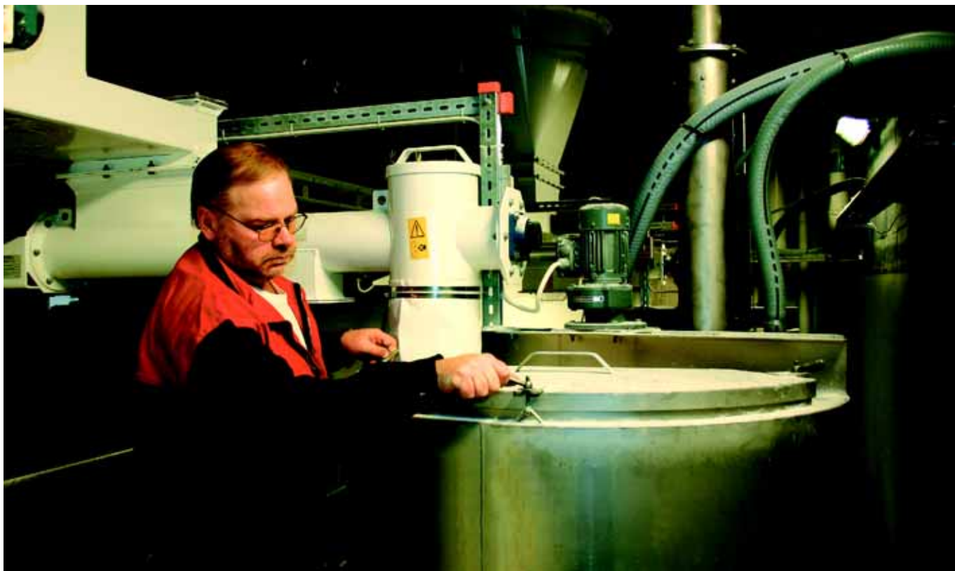
Låsning av lucka på slurryberedaren vid den nya kalkvattenberedningen på Ringsjöverket.
