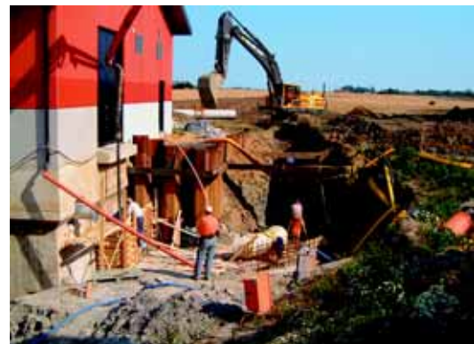
Inkoppling vid pumpstation i Teckomatorp
